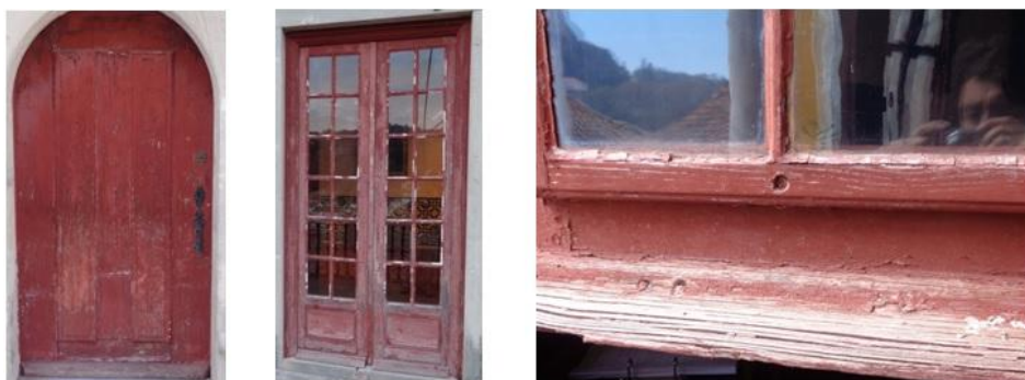
Figura 4.10 - Exemplos de nível de degradação 3
