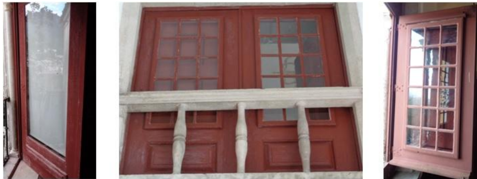
Figura 4.9 - Exemplos de nível de degradação 2
