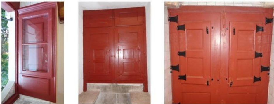
Figura 4.7 – Exemplos de nível de degradação 0
