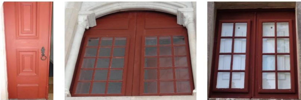
Figura 4.8 - Exemplos de nível de degradação 1
