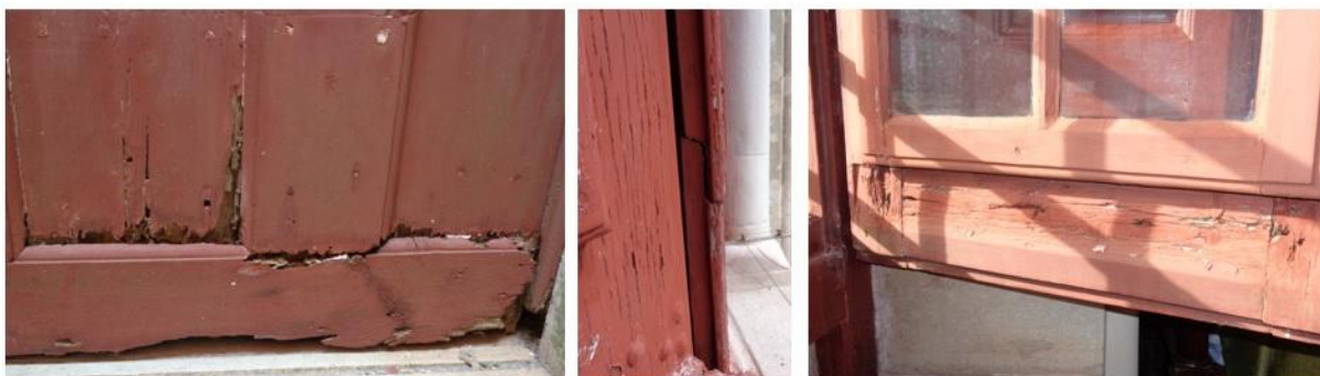
Figura 4.11 - Exemplos de nível de degradação 4
